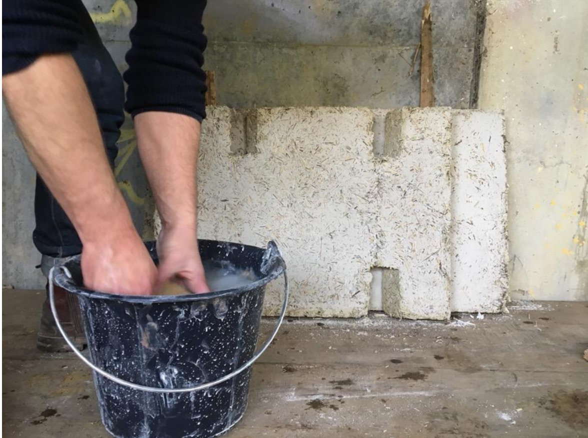
Figure 161 : Démoulage, paravents, 16/12/20, crédit Carole Lemans
