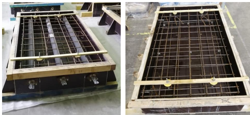
Figure 6.1 – Coffrage des dalles. A droite, coffrage adapté au chargement par post-tension et à gauche sans chargement
