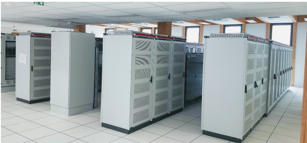
Figure 4-36 : Aperçu de la réplique du contrôle-commande de la liaison HVDC IFA2 dans le laboratoire temps réel du Campus Transfo de RTE.
