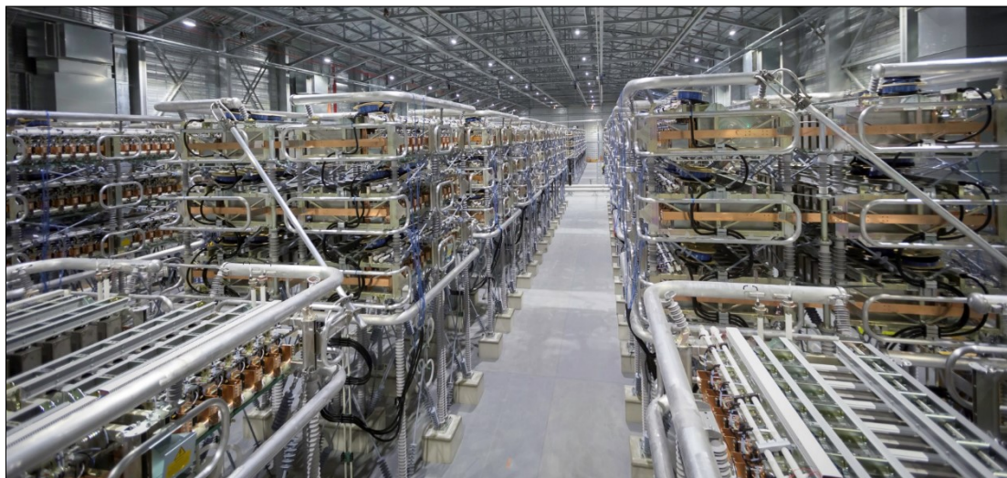
Figure 1-3 : Aperçu du hall d'un poste d'électronique de puissance pour la conversion continu/alternatif (liaison France-Espagne, source RTE).
