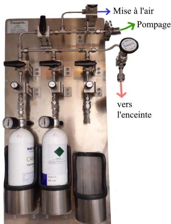
FIGURE 6.6 – Tableau de vannes et bouteilles de gaz réactifs.
