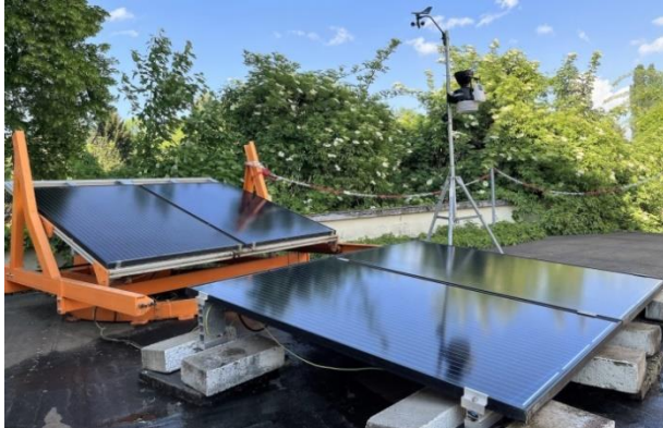
Figure 7-2 : Les panneaux photovoltaïques installés au laboratoire INSA ICUBE.
