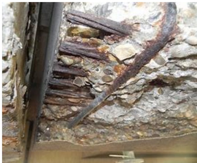
Figure 2 Béton détérioré par attaque sulfatique
