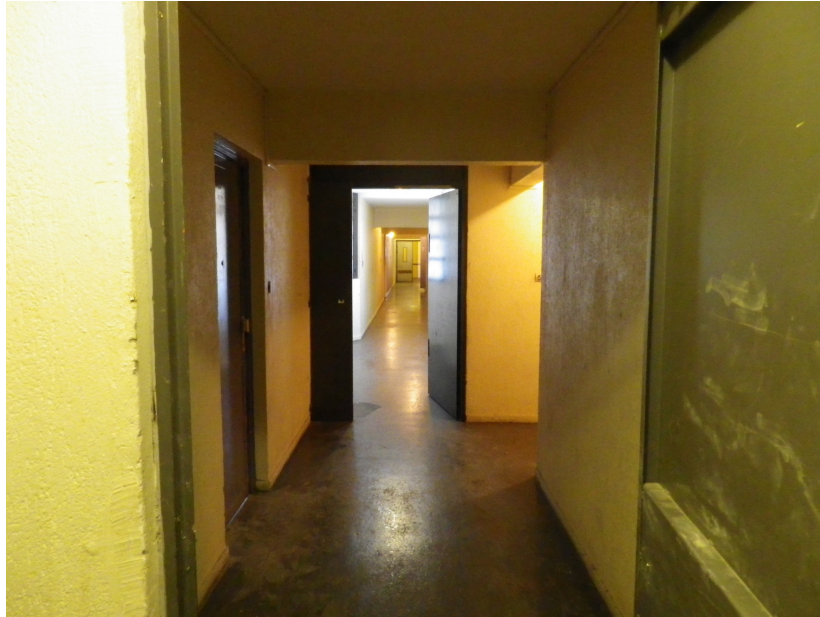
Figure 34 : Découverte d'un passage entre le 50 Arlequin et le 60 Arlequin, la serrure à digicode permettant de fermer la porte a été cassé. Photographie Mailys Toussaint, 26 mars 2016.
