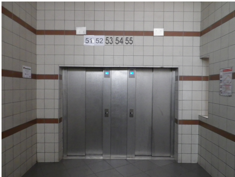
Figure 35 : Les ascenseurs du 50 Arlequin desservent deux étages supplémentaires. Photographie Maillys Toussaint, 13 novembre 2015.
