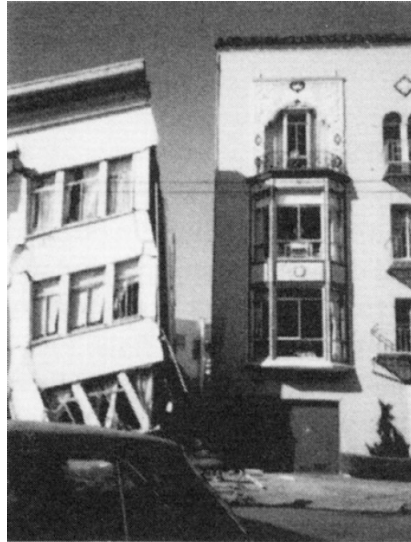
Figure 1.1: Effondrement d'un bâtiment (Loma Pietra, 1989) [60]
