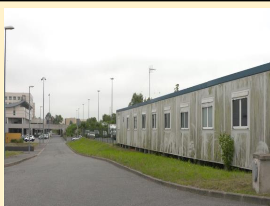
À gauche sur la photo, le nouvel hôpital et à droite, la PASS dont les murs sont salis par la mousse.
