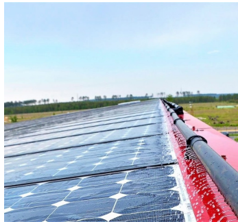
(b) Système de water spraying commercialisé par la société SunBooster
