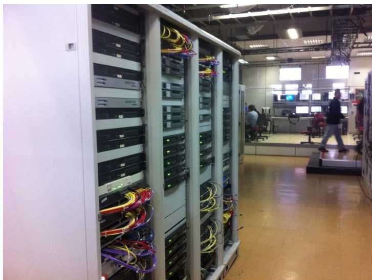
Figure 19 : Une étagère des routeurs
