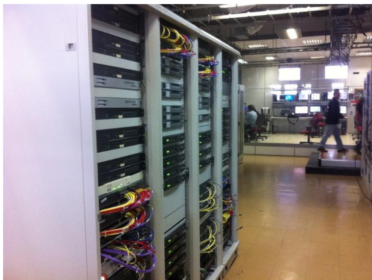
Figure 19 : Une étagère des routeurs
