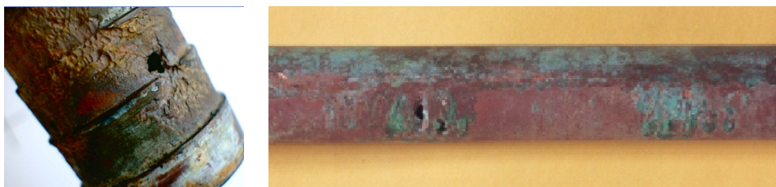
Figure IV.2 : Aspects de dégradation par érosion-corrosion sur des composants d'installations de distribution de l'eau
