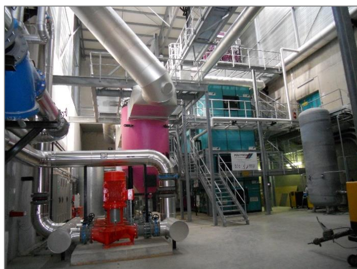
Photo 29 - Équipements de la chaufferie bois de Mende (Lozère)
