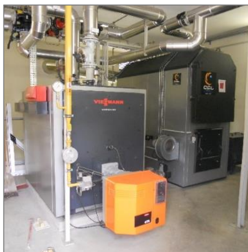
Photo 25 - Système de chauffage en cascade bois-gaz de la commune de Ramonchamp (Vosges)
