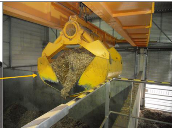
Photo 30 - Grappin automatisé en train de déplacer des plaquettes d'un silo à l'autre
