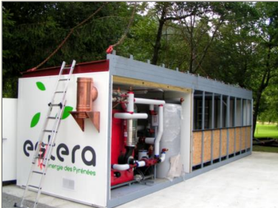
Vue de l'intérieur du module contenant la chaudière bois
