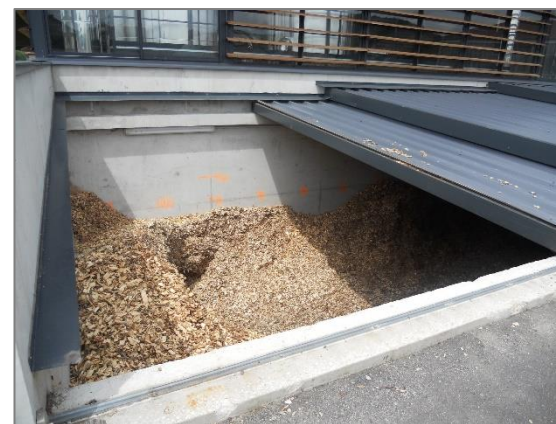
6- Plaquettes venant d'être déversées dans un silo de stockage enterré
