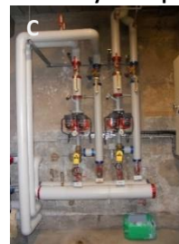
Système de contrôle du circuit hydraulique
