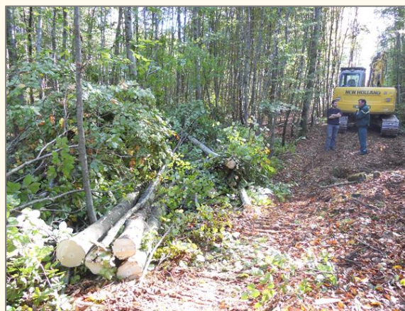
Photo B- Bois abattus et rangés en tas le long du cloisonnement
