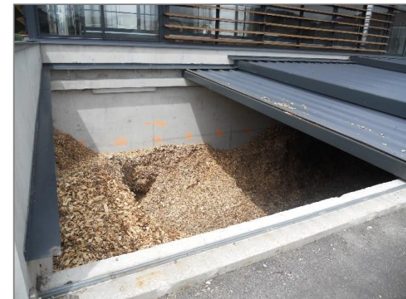
6- Plaquettes venant d'être déversées dans un silo de stockage enterré
