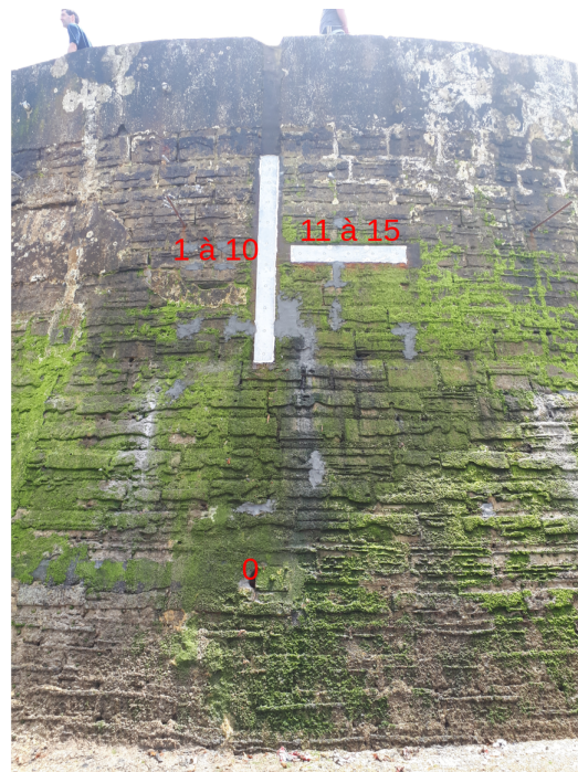
(C) Installation des seize capteurs sur le musoir nord-ouest. Le capteur zéro est en bas.
