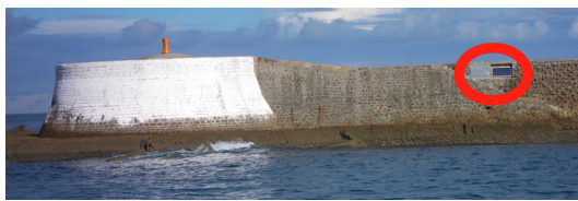
(A) Station de supervision de la digue de l'Artha. Les capteurs sont de l'autre côté du musoir peint en blanc.
