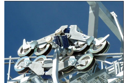
(c) Support/compression roller battery - TSD6 L'Oursière / Les sept Laux
