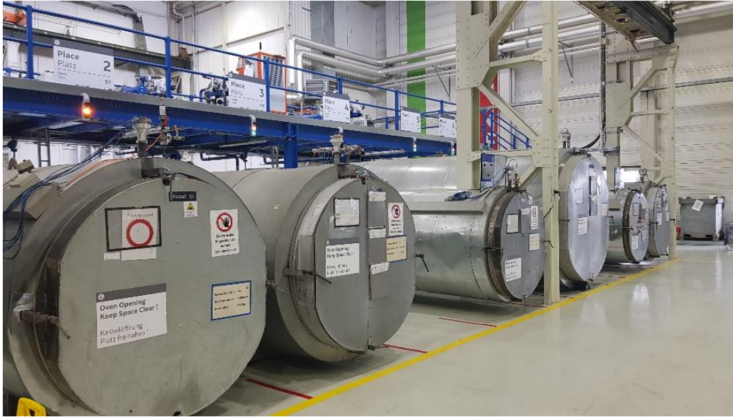
Figure 14 - Four industriel horizontal utilisé pour le séchage de la cellulose à échelle industrielle
