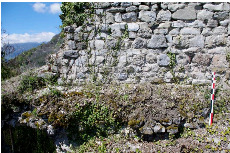
Fig. 4: Parement intérieur de la tour et départ de voûte. Cliché : L. Benoit.
