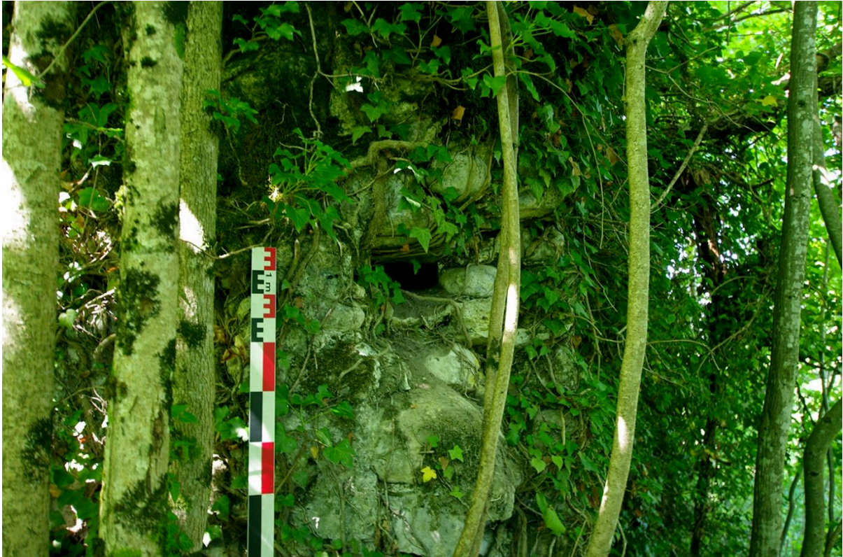
Fig. 4: Potentiel trou de poutre en lien avec une fermeture de porte. Cliché : C. Guffond.
