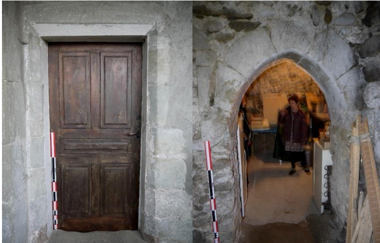
Fig. 14: Porte à linteau plat et porte en arc brisé dans la maison forte du Verney. Clichés : L. Benoit.
