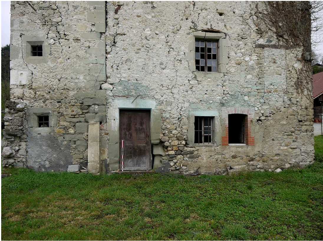
Fig. 13: Exemple de façade ancienne. Cliché : L. Benoit.
