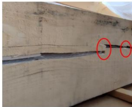
FIGURE 7.13 – Fusion de deux fissures entourée en rouge sur la poutre S09.
