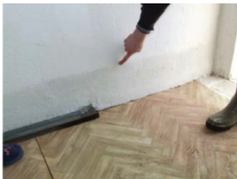
Illustration 1 : Levés de PHE – Traces d'humidité (Cerema Ouest, Xynthia, La Faute-sur-Mer, 2010)
