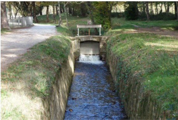
FIGURE 1.1 – Photo d'une vanne (Lac de Saint-Ferréol). ©Léo Guiot.
