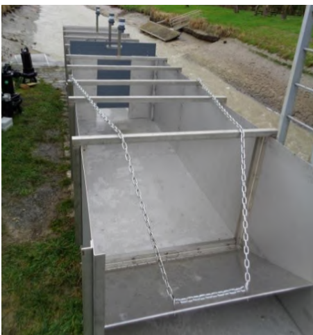
FIGURE 4.6 – Photo de la zone 4 du canal in situ , vue de l'aval. ©OFB.
