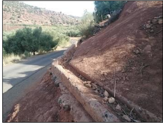
Figure 2-8: Seguia en béton abandonnée
