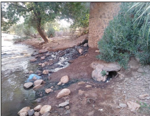
Figure 10-23: Rejet direct des eaux usées du centre Elhri dans l'oued de Chbouka
