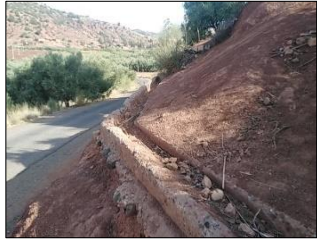
Figure 2-8: Seguia en béton abandonnée
