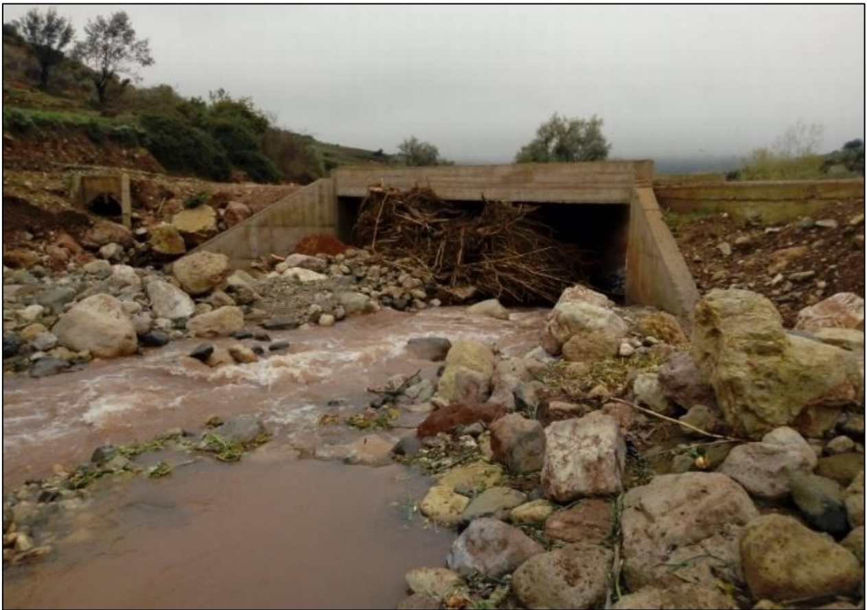
Figure 10-27: Accumulation des embâcles au niveau du pont sur Assif Tamharrart
