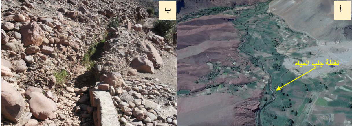
صورة 16: (أ) نقطة جلب الماء بعالية الحوض (Google Earth, 2019). (ب) ساقية بمنطقة ايت موسى تعرضت للتلف بفعل الإمتطاح ( عمل ميداني: نونبر 2019)
