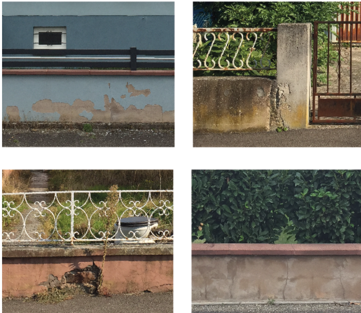
Fig. 3.17. Quelques marques du temps visibles sur les clôtures à B.
