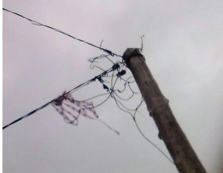
Figure I - 2 : État des câbles suite à plusieurs créations d’arcs électriques à Madagascar
