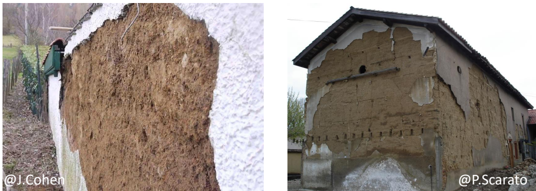
(a) Forte humidification d'un mur en terre (b) Dégâts humides d'une grange en pisé
