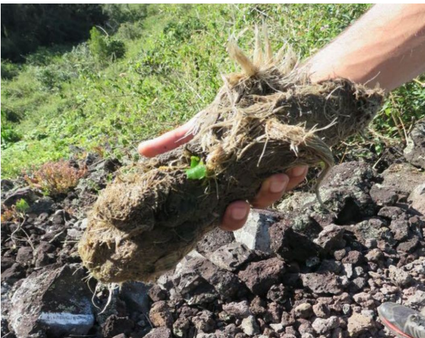
Figure 88: Bouchon formé par des végétaux extirpé de la conduite d'un captage, Roche-Plate, Lallemand J., 2019
