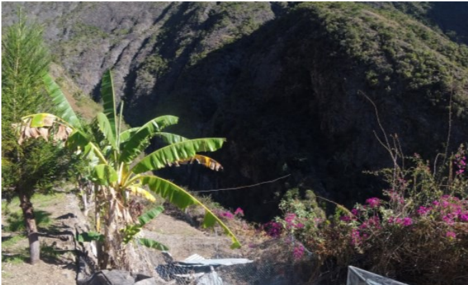
Figure 91: Conduite suspendue en pleine ravine, Orangers, Lallemand J., 2018.
