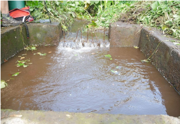
Figure 87: Absence de couverture de la prise d'eau, avec présence importante de sédiments et de matière organique en décomposition en contre bas d'un talweg, Roche-Plate, Lallemand J., 2018.
