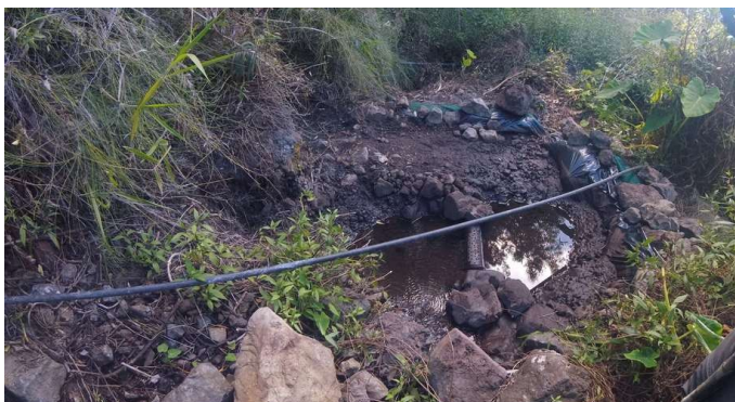
Figure 90: Captage maron avec crépine et installation de bâches et rochers avec présence de sédiments et matières organiques au sein du captage, Roche-Plate, Nicault M, 2019
