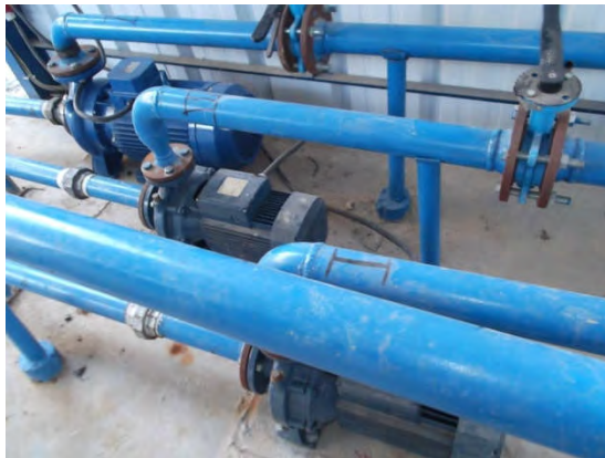
Figure I.2.8 : Le groupe des électropompes du grand canal de l'INAT
