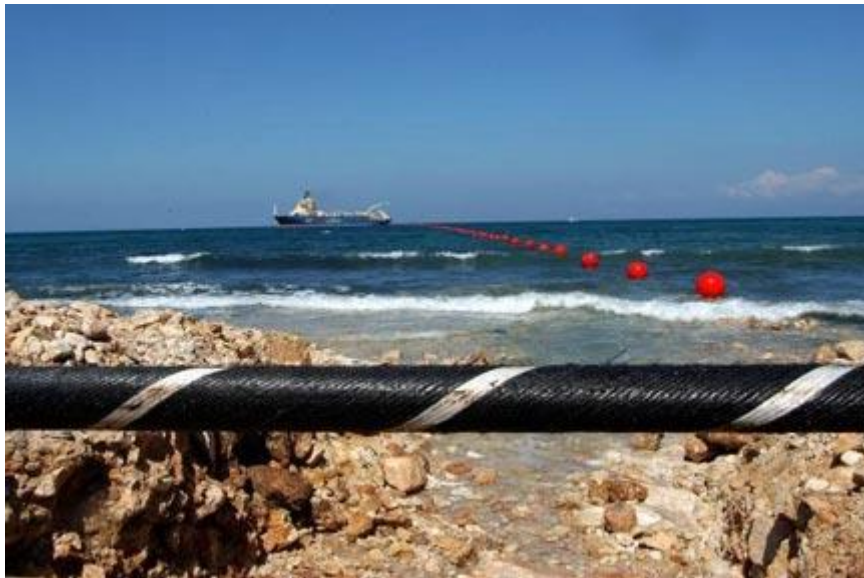
Câble SAT-3 en fibre-optique à son point d'atterrissage
