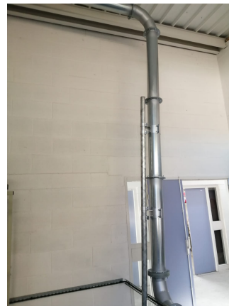
(c) Support de la tuyauterie en sortie.
