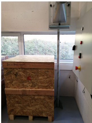
(a) Support du caisson filtrant en entrée.
