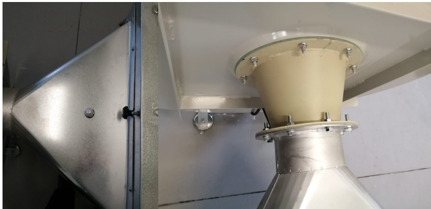
FIGURE 3.28 – Éléments de transition : diffuseur en sortie du caisson filtrant (gauche), cône de transition à l'entrée du ventilateur (droite).
