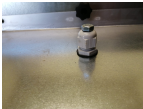
(a) Presse étoupe bouchée.
