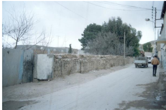
Photo n° 15: l'état actuel de l'aqueduc de Tébessa en 2021.
