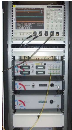
Figure 1.6 : Photographie d'une baie VH du CEA (constructeur IDIL Fibres Optiques)
