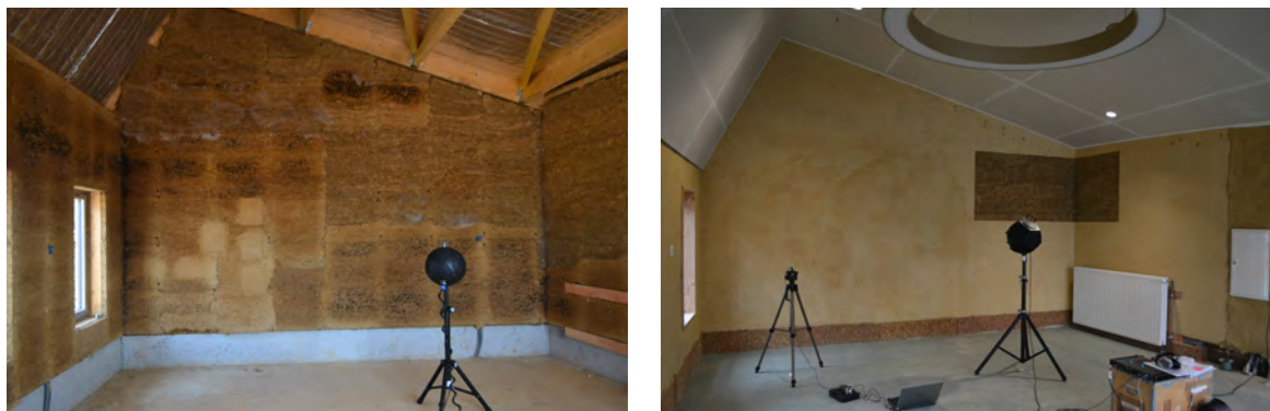
Figure 95 État de parois de la bibliothèque sans et avec enduit.
