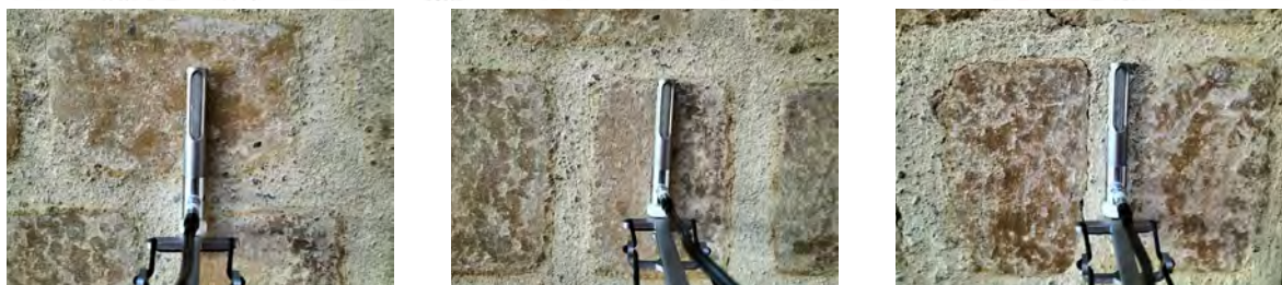
Figure 317 Mesures in situ du coefficient d'absorption acoustique par fréquence et photographies de la mesure. Mur en brique de terre crue stabilisé à la chaux (BTC) - Fégréac.
