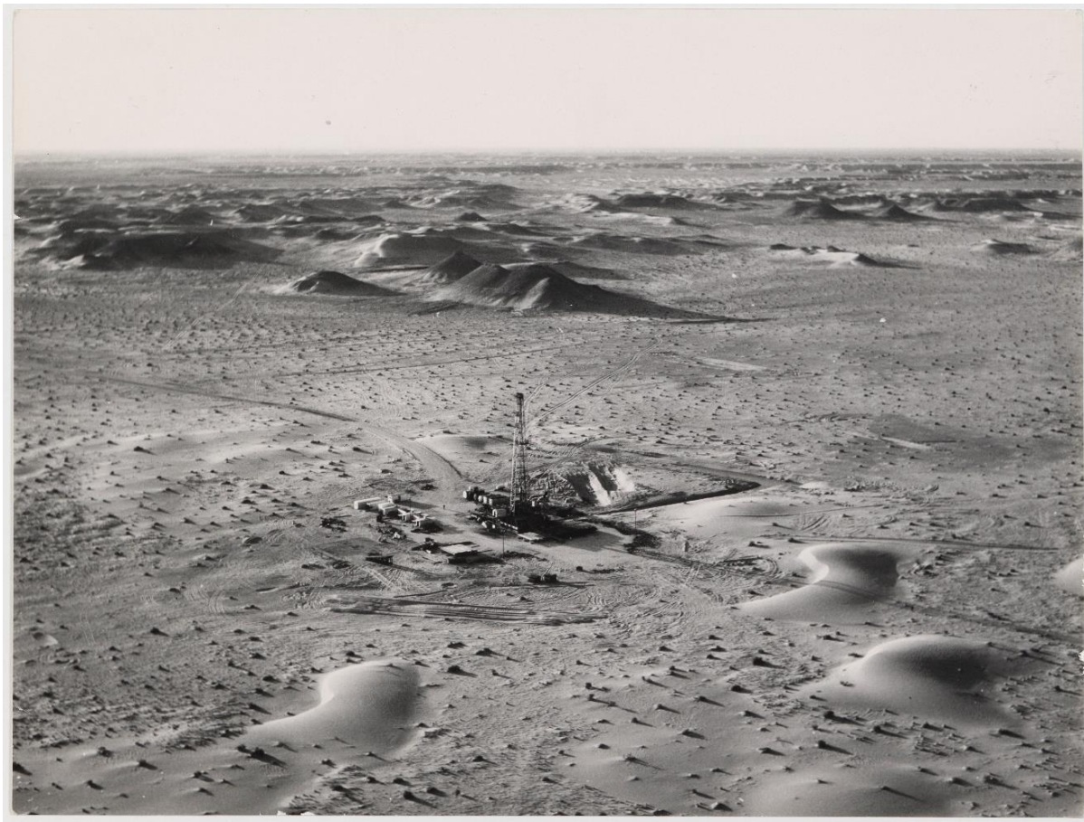
Photo 30 : Appareil de forage IDECO 2500 diesel sur le champ de Haoud Berkaoui - Ben Khala, 1967 - Photothèque Historique Total, 17V00537-14-1, Dimitri Dimka©
