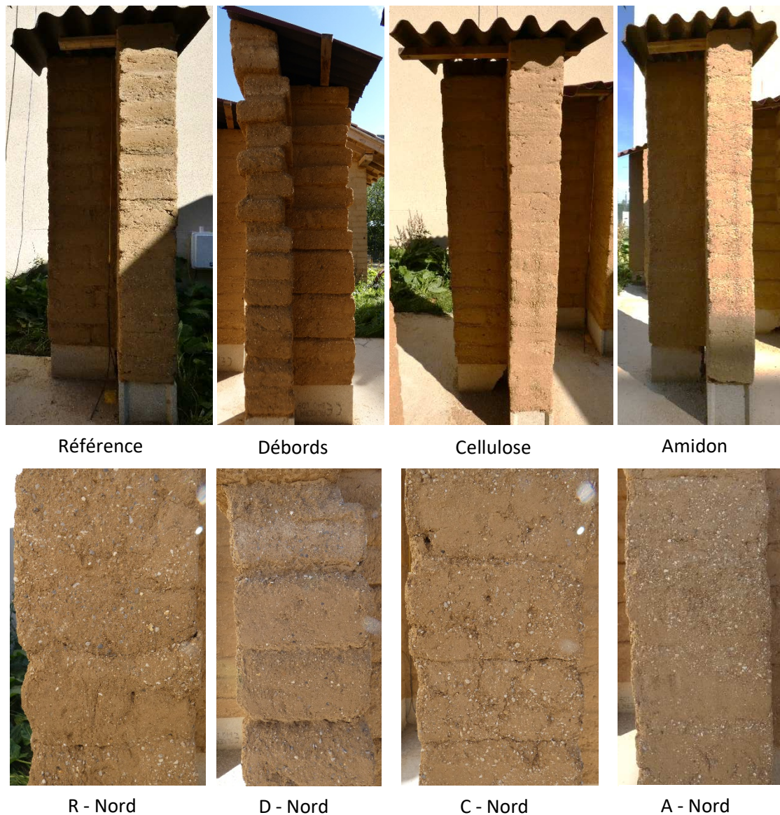
Figure 6. 11 : Aspect des murs 139 jours après le chantier
