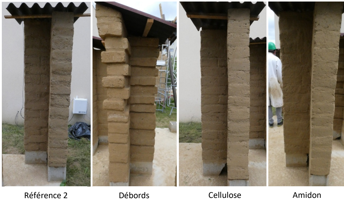
Figure 6. 9 : Aspect des murs 11 jours après le chantier
