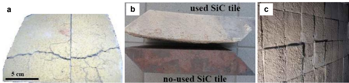
Figure I-9: Dégradations de tuiles employées dans des U.V.E.O.M. : (a) Fissuration des tuiles (Prigent, P. et al., 2009), (b) Déformation des tuiles et (c) déformation des parois (Doncieux, A. et al., 2009).
