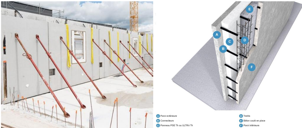
Figure 2.69 À gauche, MCI assemblés sur chantier [187] ; à droite, schéma de la coupe d'un MCI isolé [188]
