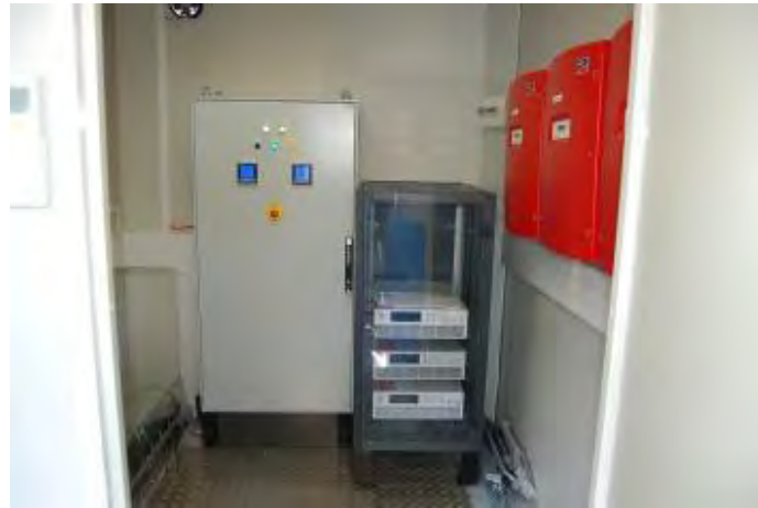
Fig 5-88: Emulateur photovoltaïque à côté des onduleurs SMA
