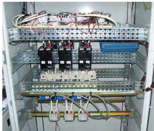
Fig 5-6: Vue intérieure de l'armoire d'interconnexion
