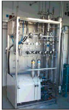
Fig 1-46 : Electrolyseur de Stralsund
