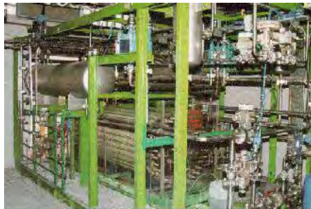
Fig 1-39 : Electrolyseur de 350kW près de Riyad
