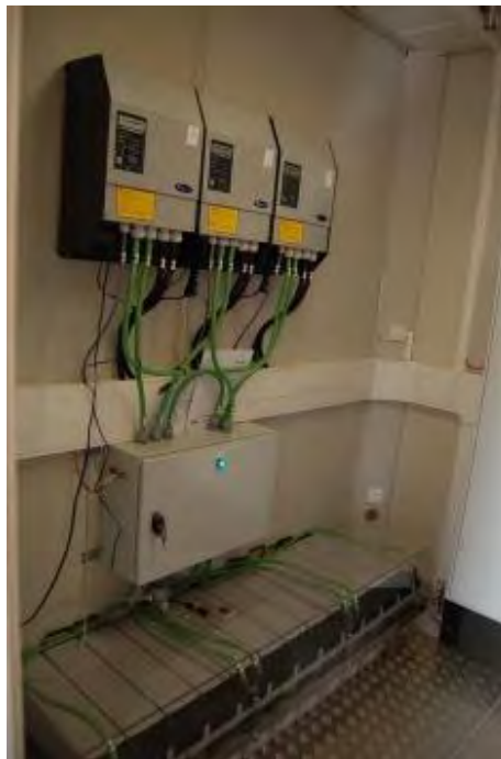
Fig 5-87: Onduleurs Studer et batteries EnerSys
