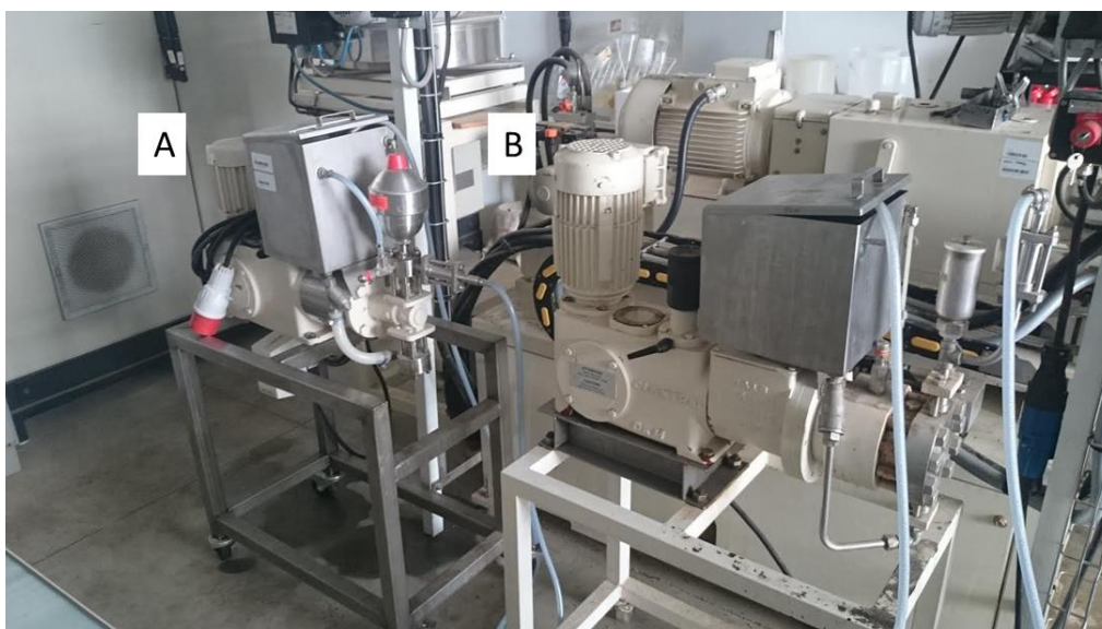
Figure III-23 Photographie de la pompe volumétrique à piston super K PP16 (A) et la pompe volumétrique à piston K20 2 PP16 (B)
