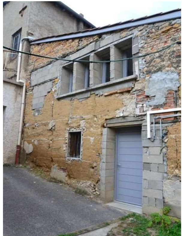
Illustration 58 : Bâtiment situé en fond de cour, au 81, Grande rue de la Croix-Rousse, Lyon 4 e . État très dégradé en 2015, du fait de l'absence de soubassement.
