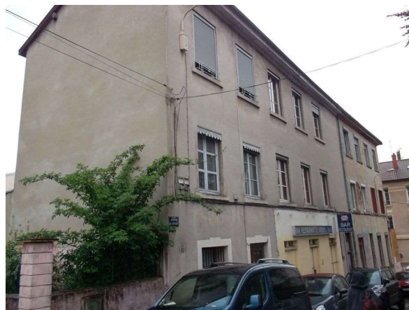
Illustration 135: Immeuble de 3 niveaux situé au 2, montée de Loyasse (Lyon 5 e , CL-218). Vue de la façade sur rue (en pisé). Photo : E. Mille.
