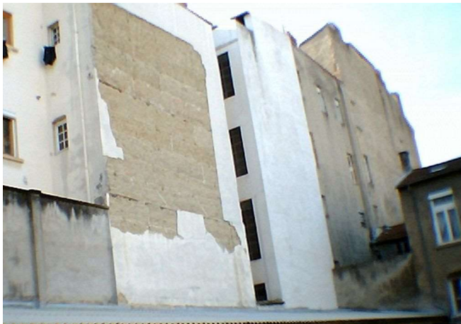
Illustration 208 : Façades nord des immeubles situés aux numéros 7, 5, 3 et 1, rue Pailleron. Au premier plan, élévation en pisé de l'immeuble de trois étages situé au n°7 (CL-202). Photo : Service des Balmes de la Ville de Lyon.
