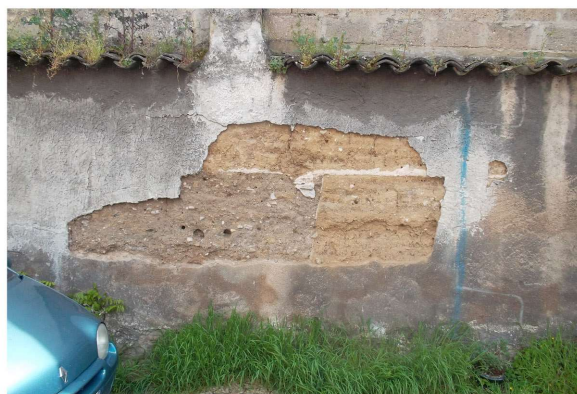
D : Mur de clôture en fond de parcelle, rue des Tuileries, Lyon 9 e (Photo : E. Mille).
