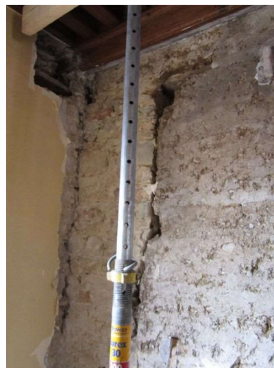
Illustration 153 : Vue du pisé du pignon nord du 1, rue de Nuits. Jonction avec le chaînage d'angle. Photo : Service des Balmes
