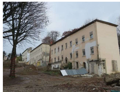
Illustration 169 : Bâtiment est de l'ancienne clinique de Champvert (Lyon 5 e , CL-227). État en 2017 pendant le chantier de reconstruction. Photo : E. Mille.
