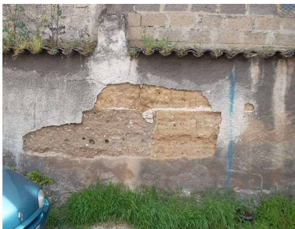
Illustration 162 : Mur de clôture situé en fond de parcelle, au 13, rue des Tuileries (Lyon 9 e , CL-350). Photo : E. Mille.
