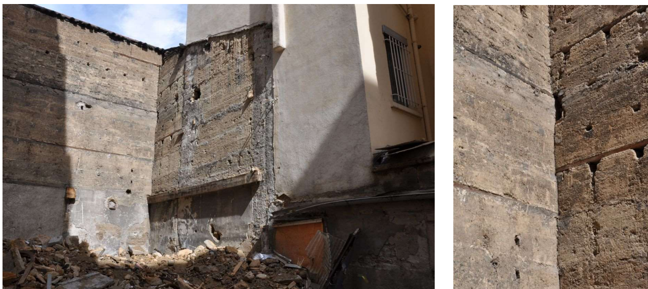
Illustrations 199 et 200 : Ensemble d'immeubles situés aux 23, 25 et 27, rue du Mail (CL-178, 179 et 180). Détail des élévations en pisé au nord-ouest de la parcelle du n°25, après démolition du bâti (photos : A-S. Cléménçon).
