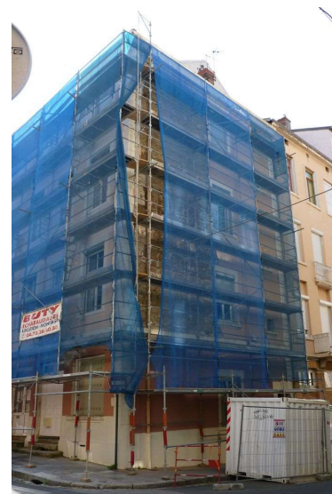
Illustration 160: Immeuble de 4 niveaux situé au 17, rue Ozanam (Lyon, 1 er , CL-017). Photo : IPPL.
