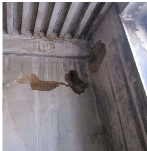
Illustration 145 : Immeuble du 4-6 rue Dumenge. Pisé du mur pignon ouest visible à l'occasion d'un dégât des eaux. Photo : Service des Balmes de la ville de Lyon.
