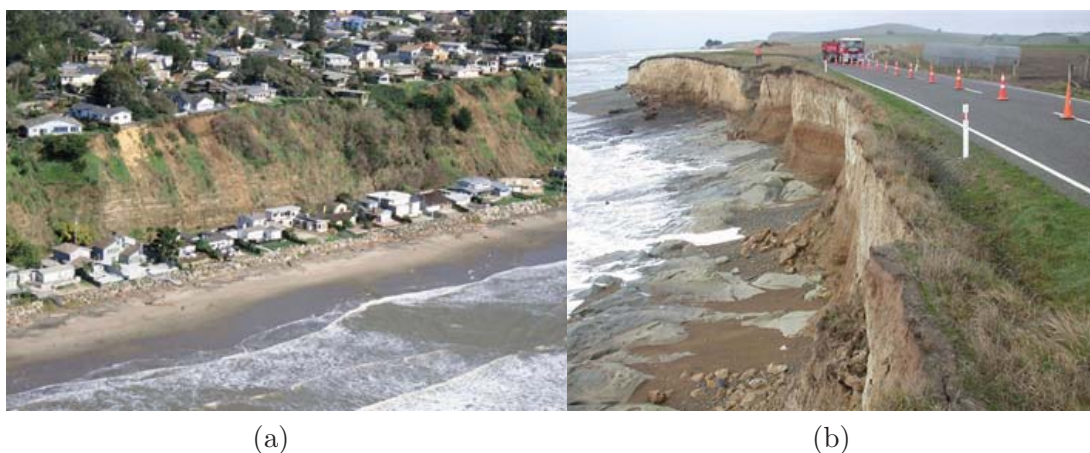
FIGURE 2 – Photos d'un glissement de terrain en Californie lié à des pluies diluviennes et l'attaque des vagues suite à la tempête provoquée par le courant El Nino en 1997 (gauche) (Ref : http://aptos-ca.purzuit.com/ ) et d'une route en bord de falaise (droite) (Ref : http://christiancapell.blogspot.com/2010/07/coastal-processes-and-landforms.html ).
