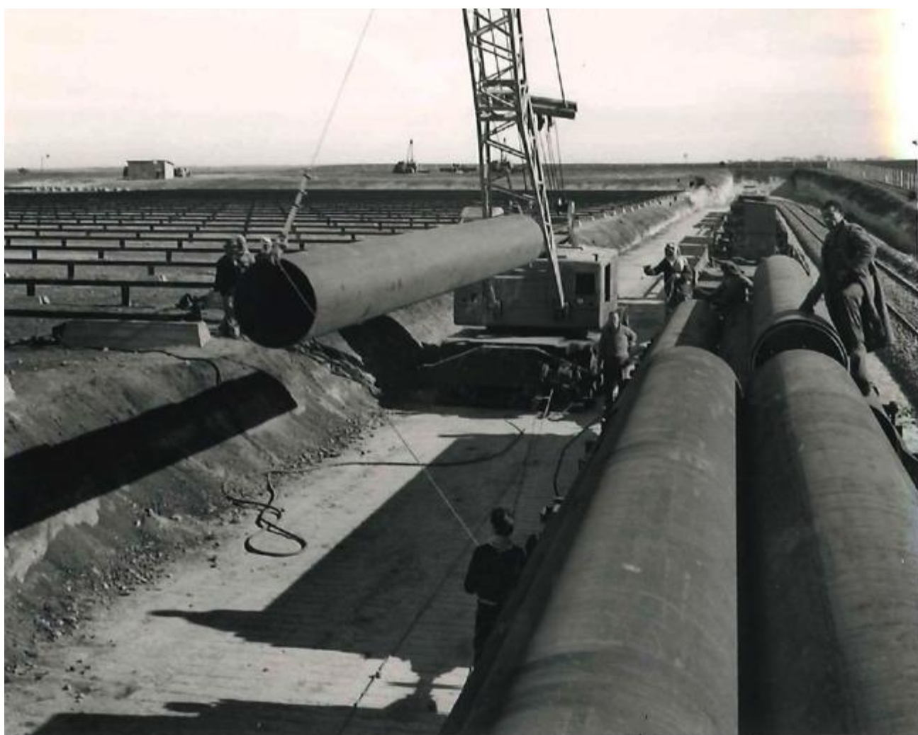
Photo 1 : Stockage des tubes au dépôt de Homs pour le pipe-line de 26'' reliant Kirkoûk au terminal de Baniâs en 1951
