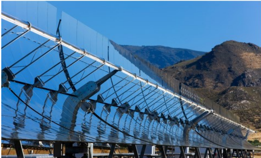
Figure 4 : Centrale cylindro-parabolique d'une puissance nominale de 340 MW installée en Arizona, USA [16]
